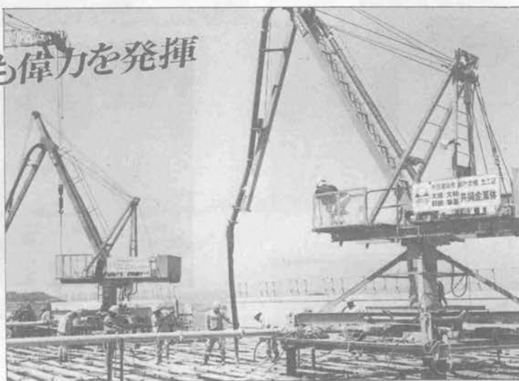
(本四架橋現場設置例)
