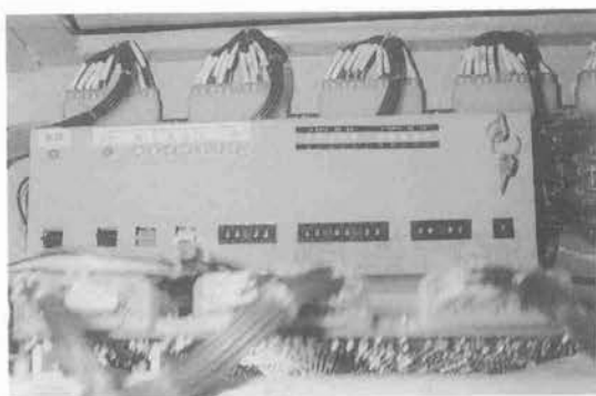
写真-7 エラー表示盤
