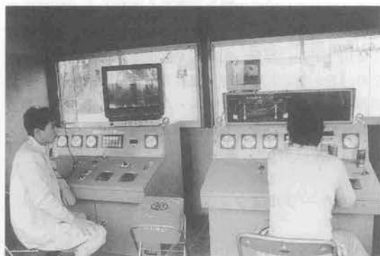
写真-6 ストランド引出し制御室
