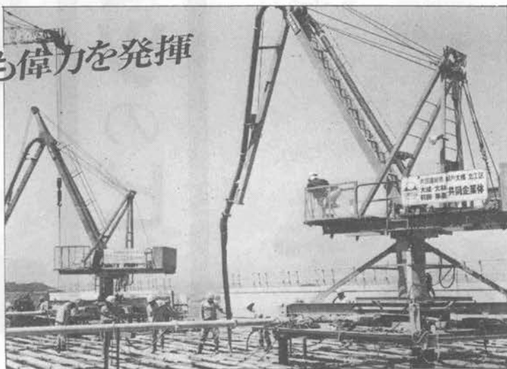
(本四架橋現場設置例)
