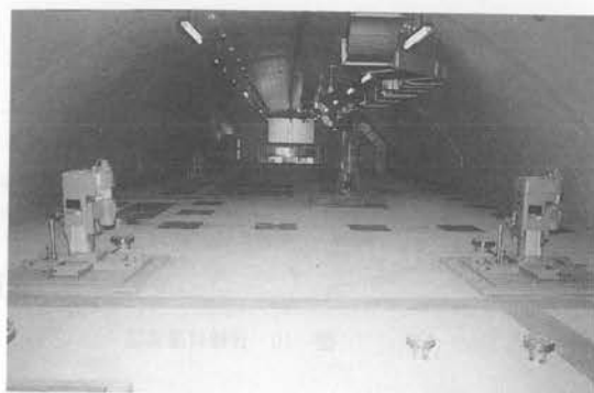
写真-5 水処理施設全景
