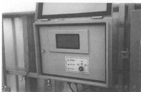
写真—8 本体制御盤
