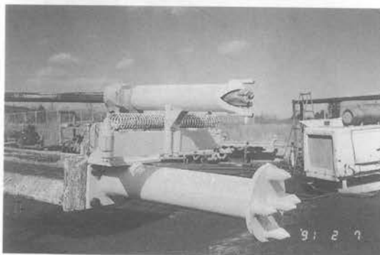
写真—37 ウイングコントローラ
