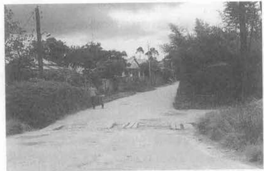
写真-4 点在するポットホールと横断水路
