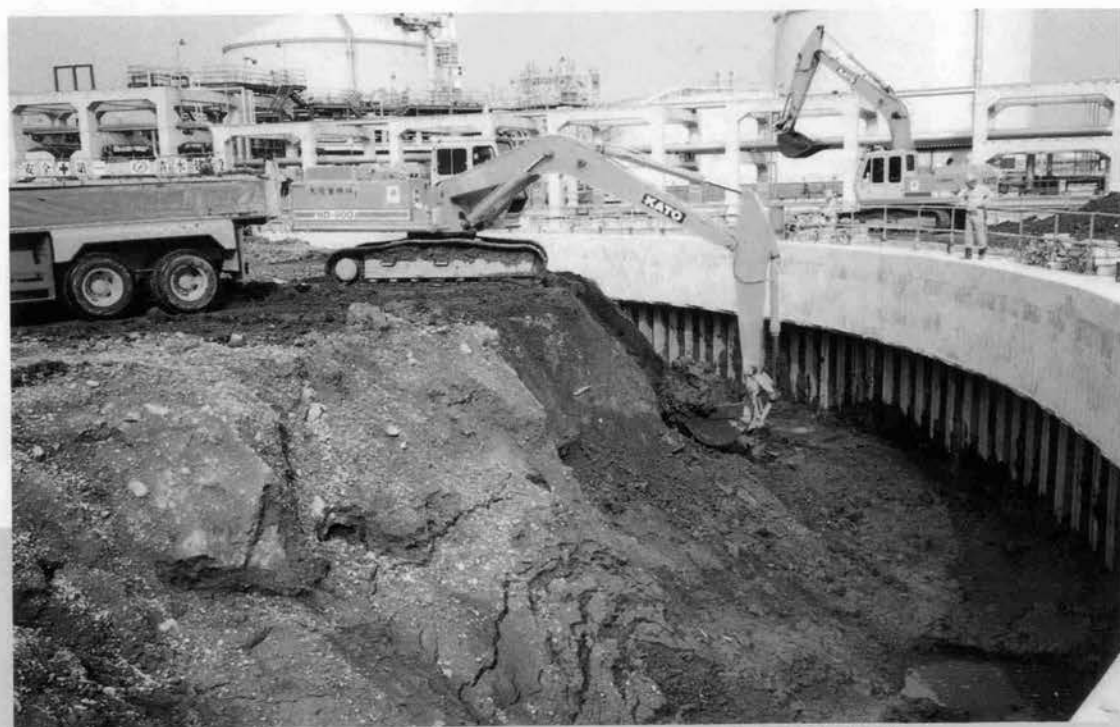
⇩ リングコンクリートによる表層部の補強(表層部の掘削)
