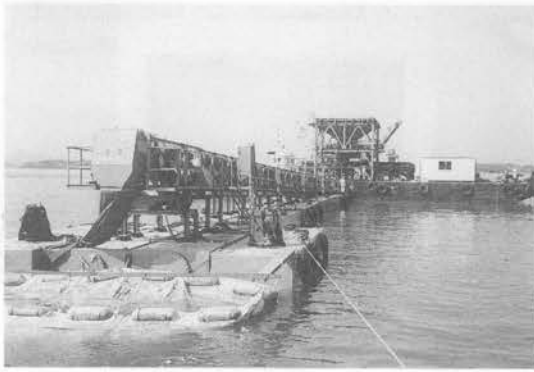
写真-64 U型水上コンベヤ
