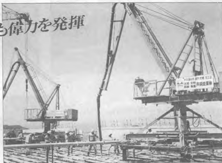
(本四架橋現場設置例)
