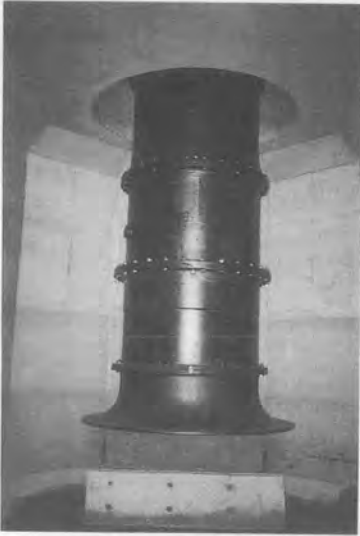
2. 主ポンプと過流防止壁
