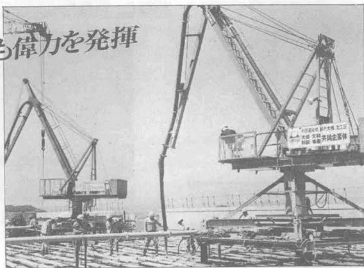
(本四架橋現場設置例)
