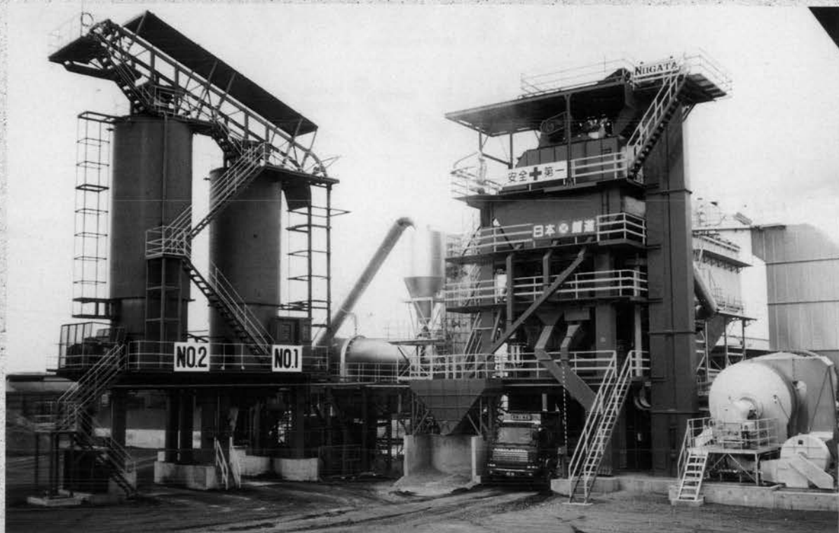
◆併設ドライヤ方式(アスファルトリサイクルプラント)(日本舗道)
