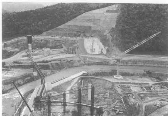
写真-2 右岸側ベルトコンベヤ全景 (右岸から左岸を望む)
