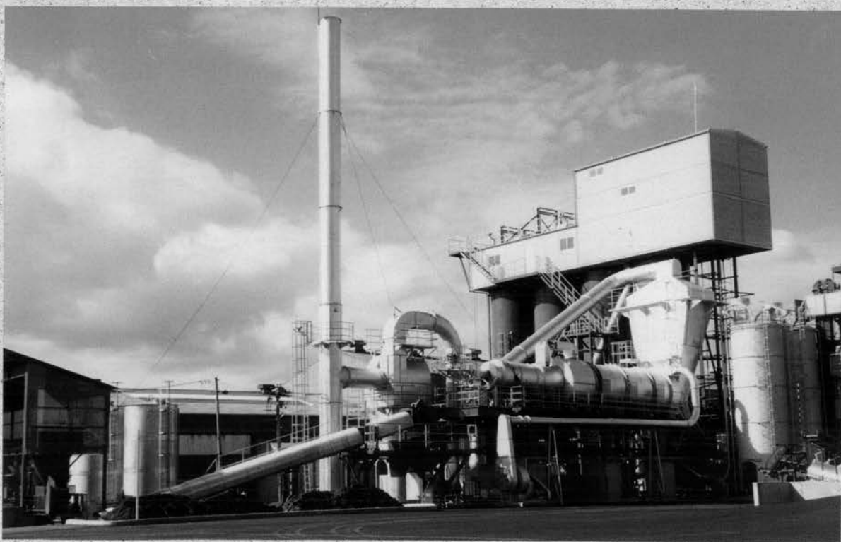
◆専用ドラムミキサ方式(アスファルトリサイクルプラント)(日本舗道)
