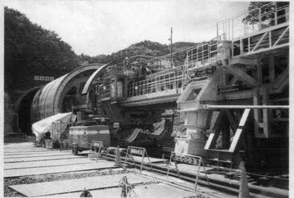
⇨ 掘削覆工併進機械後方設備 (秋間トンネル(東)工区)
