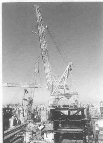
写真-3 3500型ジブクレーン
