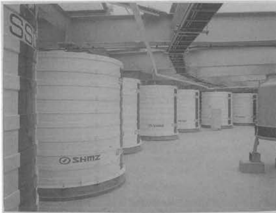
写真-4 スーパースロッシングダンパー
