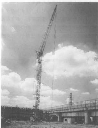
写真—3 ラジオ波によりクレーンに発生する異常電圧を防止する電気回路式の防止装置
