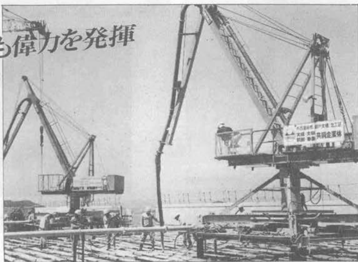
(本四架橋現場設置例)
