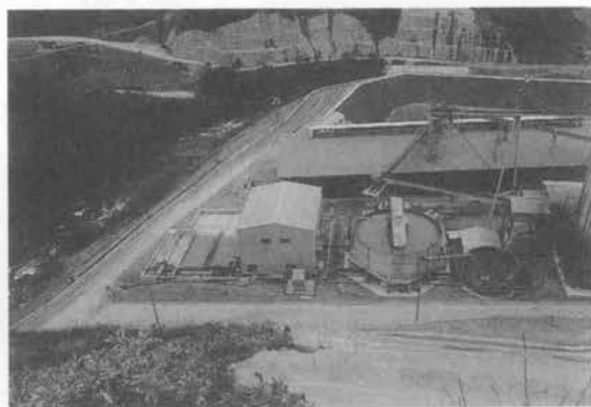
写真-16 濁水処理設備
