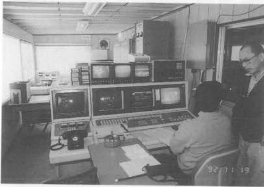
写真-7 中央制御室
