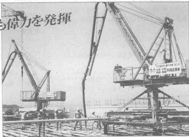
(本四架橋現場設置例)
