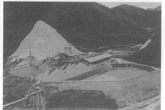
写真—4 骨材製造設備
