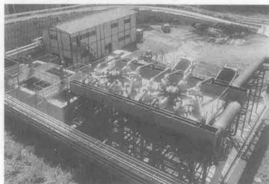
写真-1 サイクロン前処理設備
