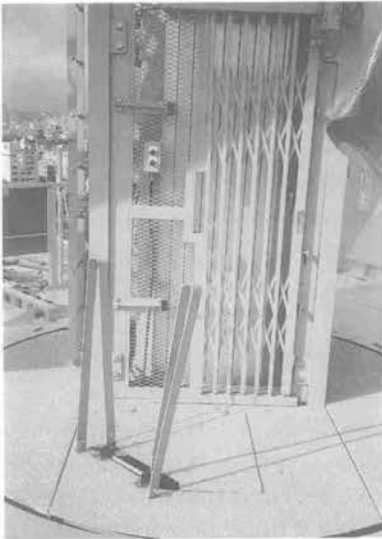
写真-2 建築用タワークレーンに設置されたエレベータ
