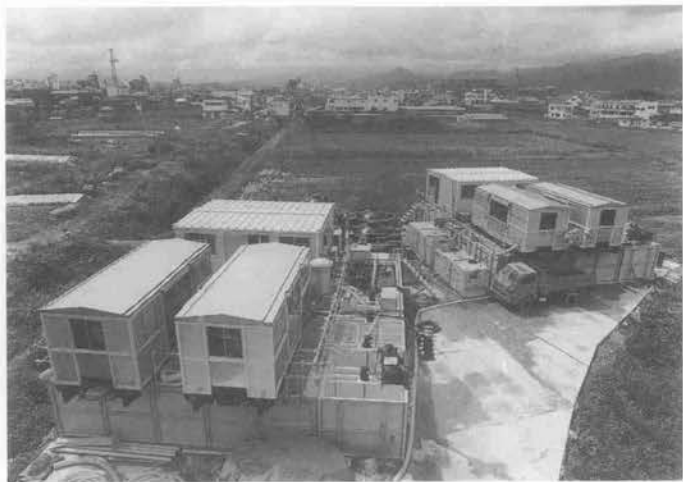
写真-1 ポリマー泥水処理装置
