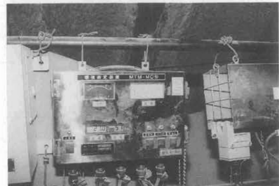
写真-2 設置された各種計測器
