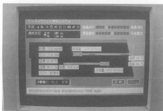
写真—4 モニタ画面による坑内環境集中監視状況
