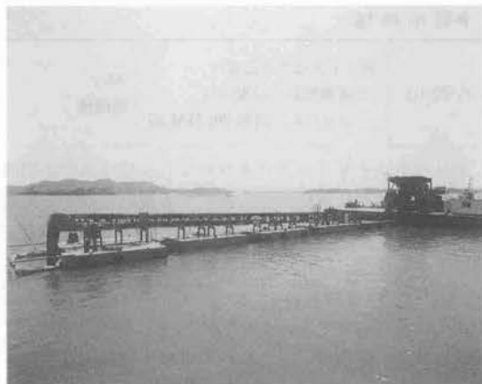
写真-1 システム全景
