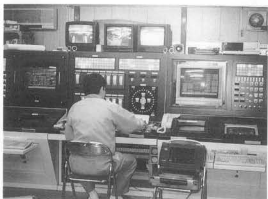
写真-1 中央制御室
