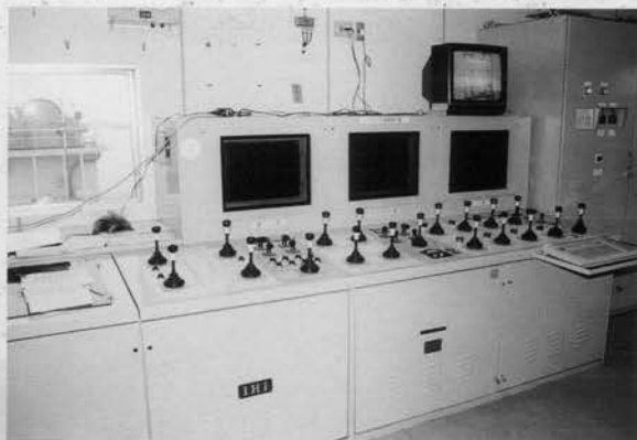
◆ プレーシングバージ司令室(自動操船装置)
