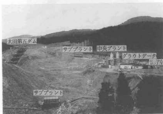
写真-2 全自動グラウチングシステム全景
