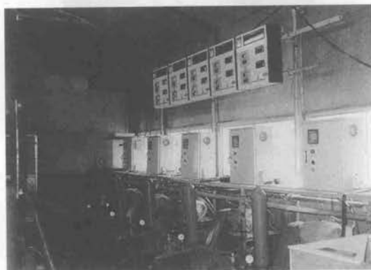
写真-5 サブプラント内にあるサブプラント状況表示盤
