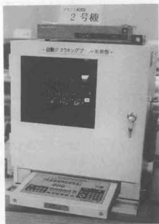
写真-3 グラウトデータ管理室内にある自動グラウチングプラント制御盤
