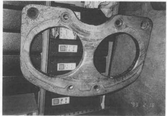
写真-1 バルブプレートの摩耗例
