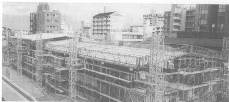
写真-22 快適ルーフを架設したマンション工事（外部のタワーと電動クライミング装置でリフトアップ）
