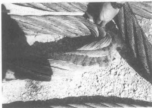
写真-3 形崩れが重度の1000 mm スリングロープ
