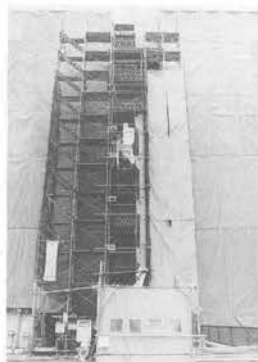
写真-1 システム全景
