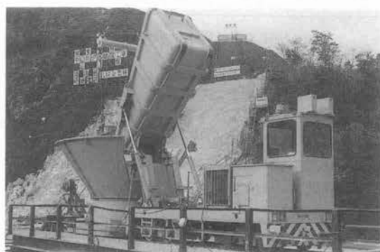
写真-1 システム稼働状況
