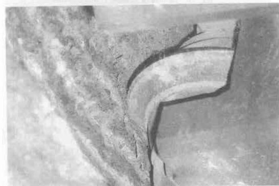
写真-2 破碎状況
