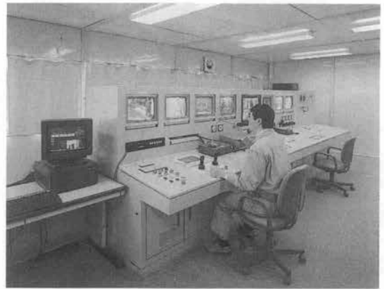
写真-9 中央制御室
