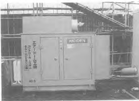
写真-4 非常用自家発電機
