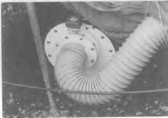
写真-5 給気側配管接続状況
