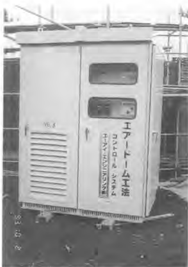
写真-3 エアコントロールシステム
