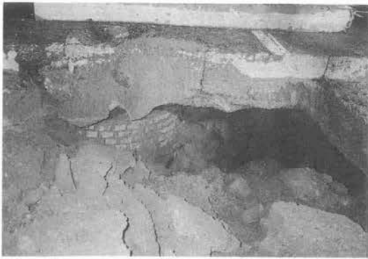
写真-1 空洞の内部状況
