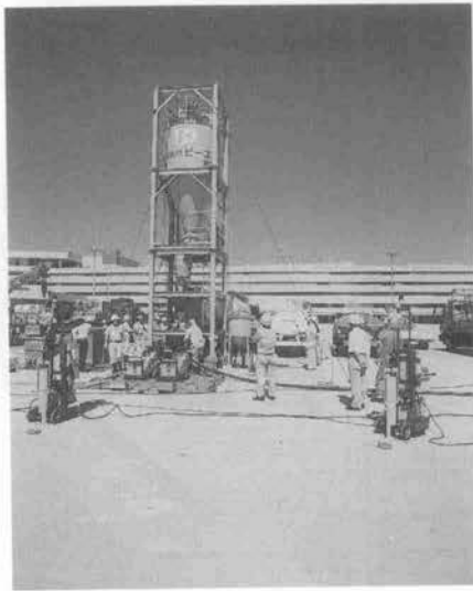
写真—2 グラウトプラント
