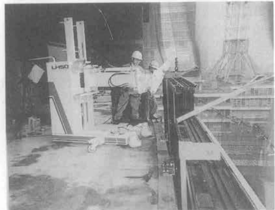
写真-6 ガラスカーテンウォールの取付 （大阪市内のオフィスビル建設現場）
