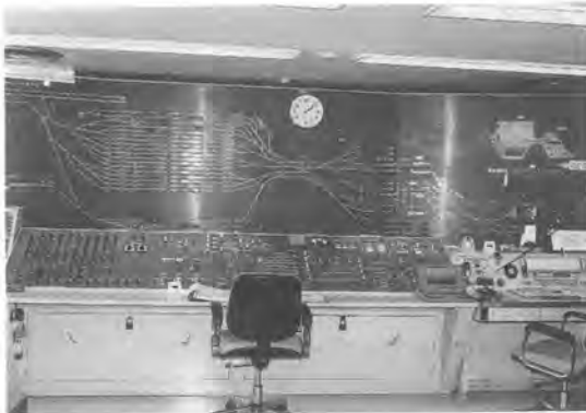
写真-4 信号取扱所の管制表示板
