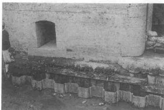
写真-13 漏水および洗掘防止鋼矢板
