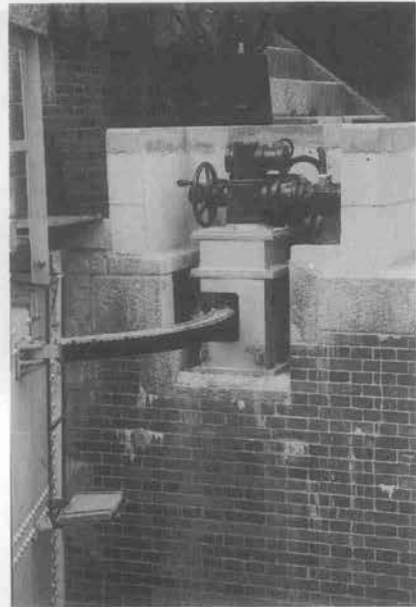
写真-19 電動式開閉機
