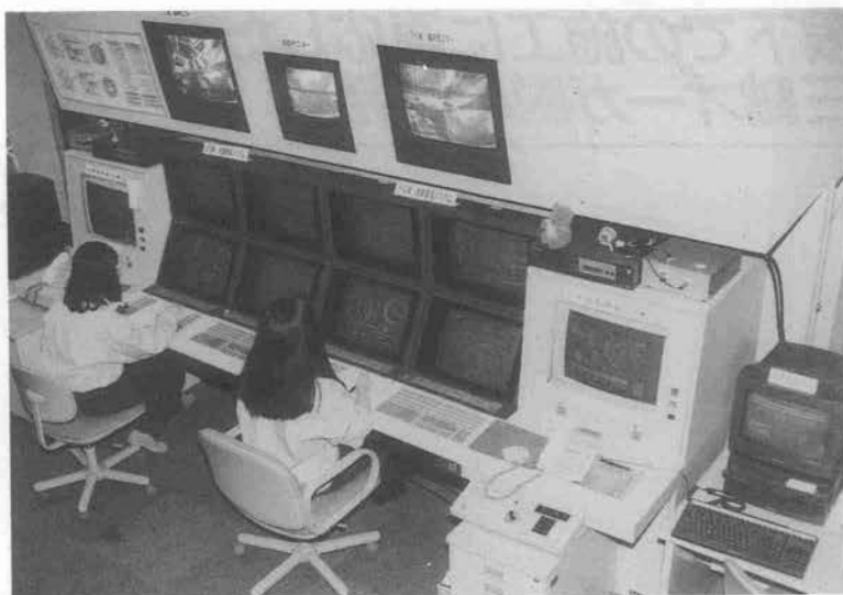
写真-3 中央制御室
