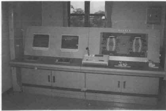
写真-20 中央操作盤
