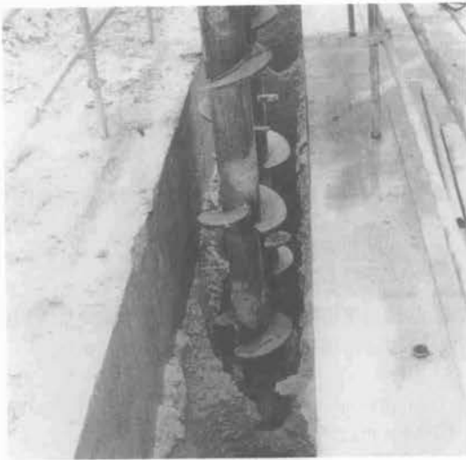
写真—1 越流部掘崩し
