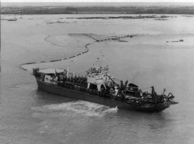
♡トレーリング・サクション・ホッパー・ドレッジャー による埋立工事
