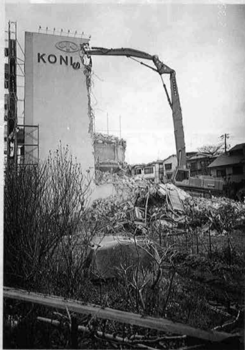
⇨ 国道2号線沿い ビル解体作業 40t級 24mロングブーム、カッタ使用
