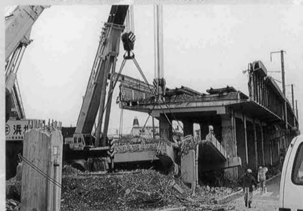
⇨ 山陽新幹線 六甲トンネル東口附近 落下した床版を再使用のため仮置場への 移動作業 500t吊と300t吊クレーン使用
