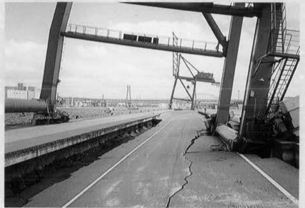
⇨六甲アイランドの埠頭の沈下破壊状況
