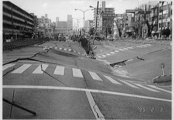
⇨神戸高速鉄道 大開駅附近 地下鉄の陥没現場
