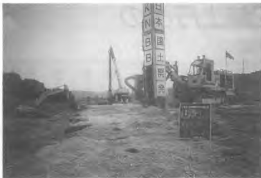
写真—6 穿孔状況
