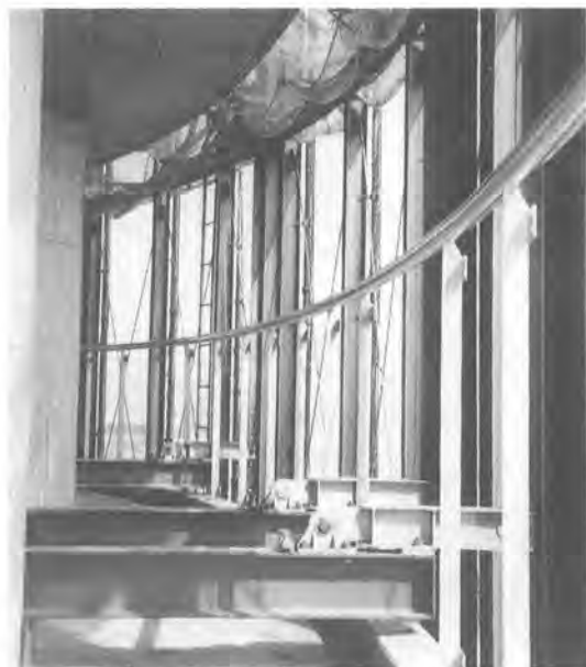
写真-3 明るい外部養生設備内部
