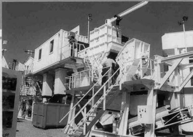
◀ KRUPP社の建設廃材(コンクリート等)クラッシングプラント
