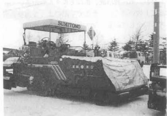
写真—1 断熱保温対策を施したアスファルトフィニッシャ
