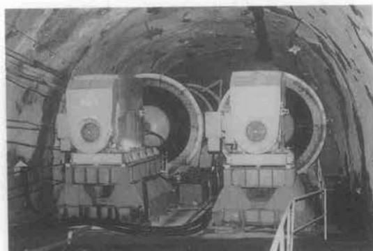
写真-12 大型軸流送風機
