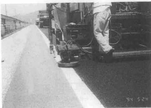
写真—21 サイドフォーマⅡ使用状況(アスファルト舗装の縦ジョイントすり付け状況)
