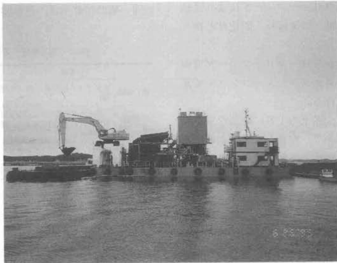
写真-2 アンドロメダ No.1 全景
