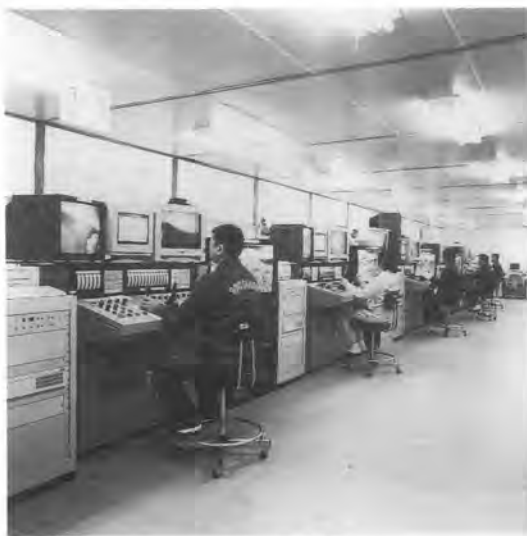
写真-9 運転操作室
