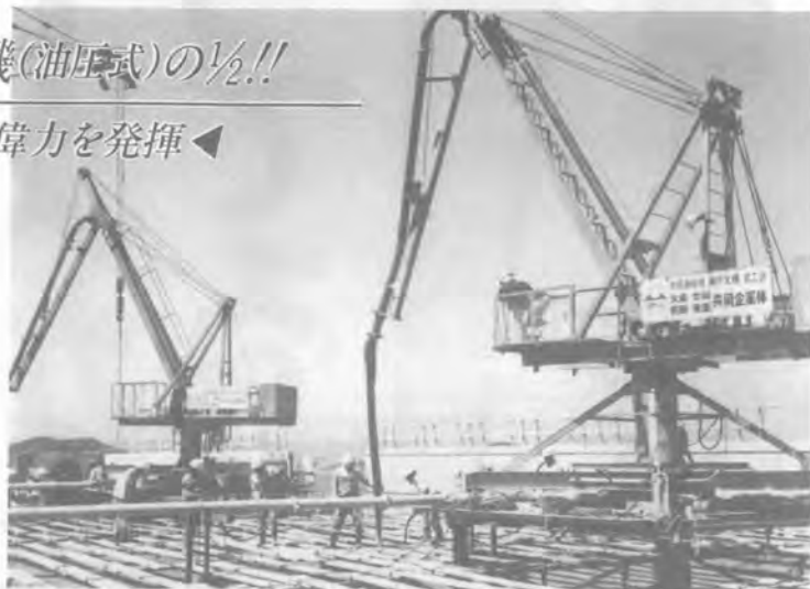
(本四架橋現場設置例)
