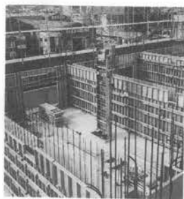
写真一 設置状況 (マンション)
