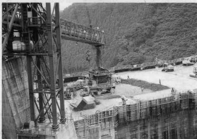
◆ 浦山ダム (ダム上流側より) コンクリート打込用ベルトコンベヤ (幅900mm, 速度120m/min, 最大運搬能力475m 3 /h)
