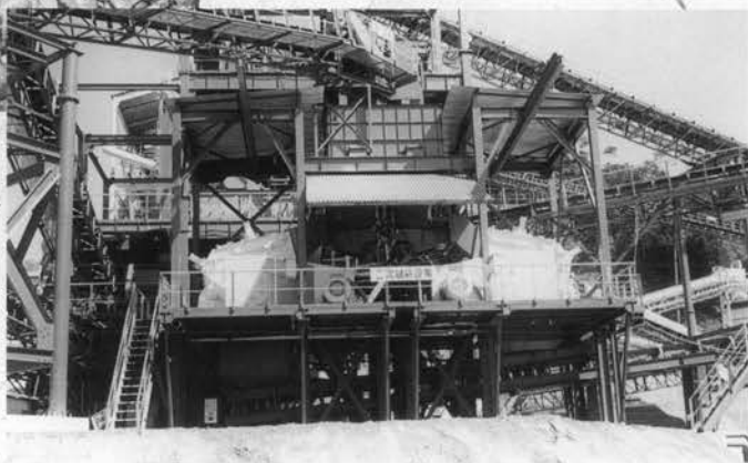
⇨ 日吉ダム 製砂設備：オートフォールミル (処理能力70t/h)
