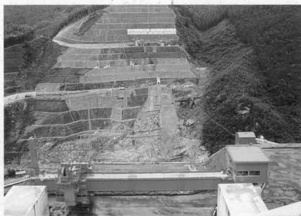
⇨ 富郷ダム (右岸側より) 両端移動式ケーブルクレーン (20t吊, 移動距離22m)
