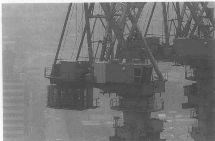
写真—4 制振装置タワークレーン
