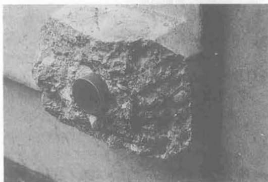
写真—4 突起コンクリートの欠損
