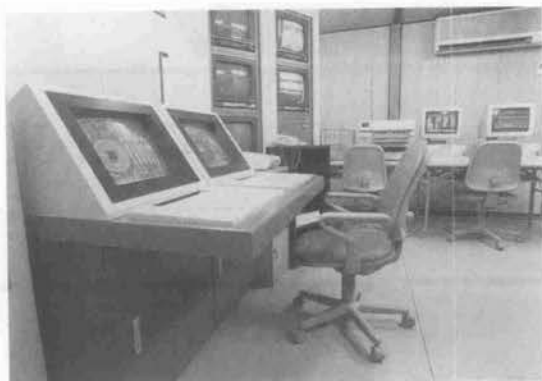
写真-20 中央管理室
