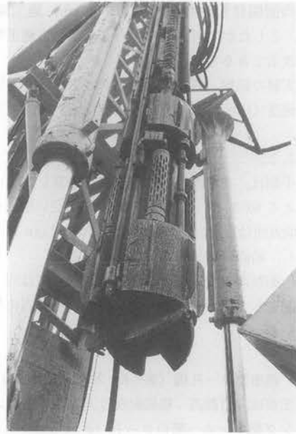
写真-14 テラシステム
