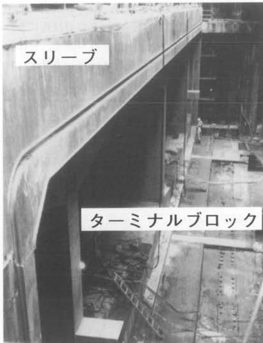
写真-1 ターミナルブロック収納状態 (到達立坑構築用山留め内)
