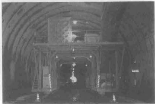
写真-24 トンネル換気装置
