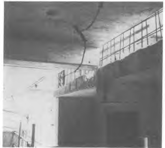
写真-1 EXP ジョイントの段差
