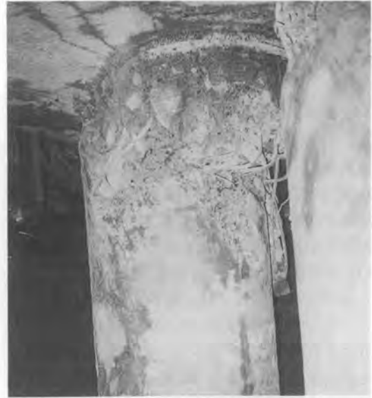
写真-2 杭の損傷状況 (沈下側)
