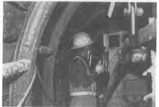
写真-2 画像モニタによるポンプ操作
