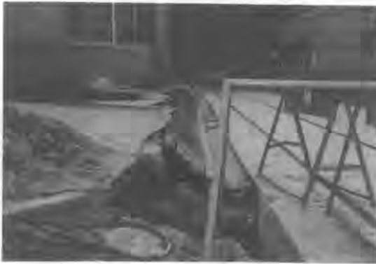
写真-2 道路に生じた亀裂
