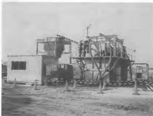
写真—4 中継泥槽
