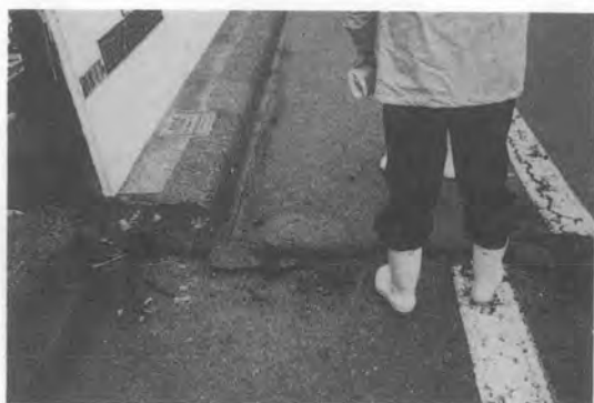
写真-4 西宮IC橋…横ずれ状況
