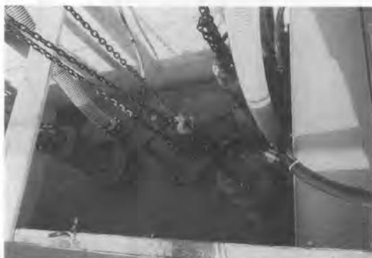
写真—5 攪拌ポンプおよび送泥ポンプ
