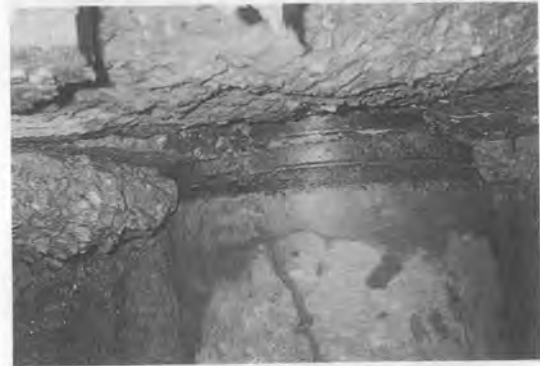
写真-3 杭の損傷状況 (浮上り側)
