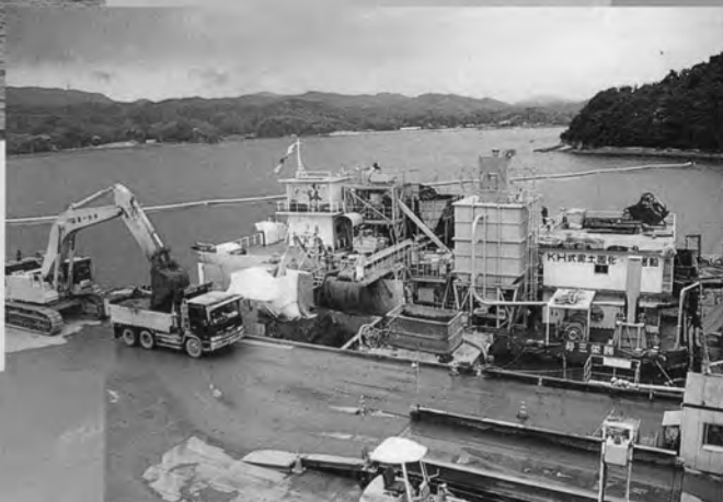
◀ 固化処理プラント全景
