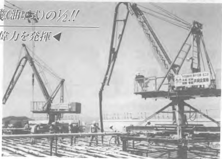
(本四架橋現場設置例)
