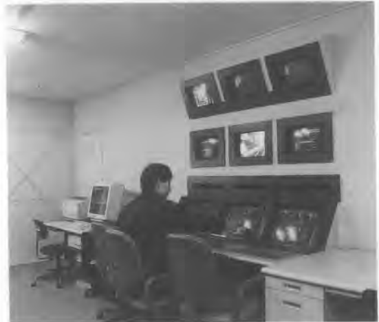
写真-2 中央制御室操作状況
