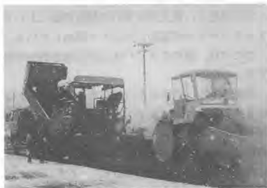
写真-2 寒冷時におけるアスファルト舗装
