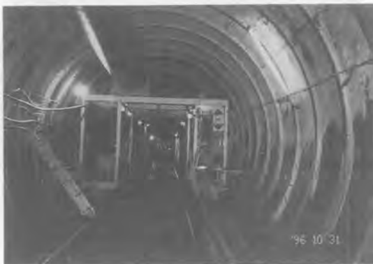
写真—2 TBMバックアップシステム
