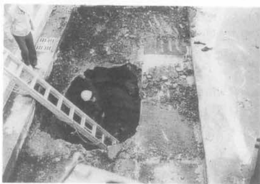
写真—1 空洞箇所開削状況
