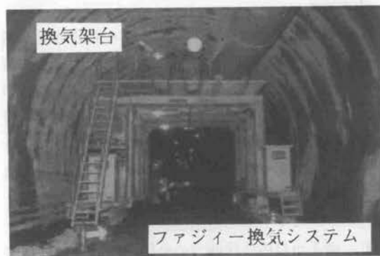
写真-1 坑内換気架台
