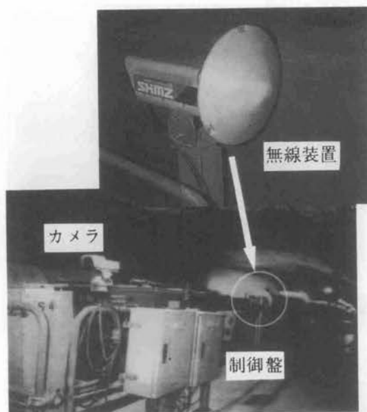
写真-3 換気架台上無線関係機器
