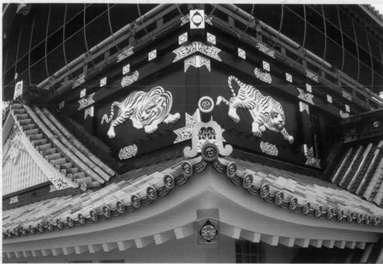
↑5※改修後の伏せ虎 (銅板の打ち出し成型, 金箔を3度押しの上, 墨差し仕上げしている)
