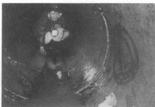
写真-1 管の腐食状況
