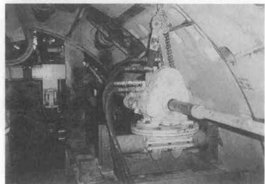
写真—5 二次ボーリング機坑内掘付状況(受入側シールド機内)
