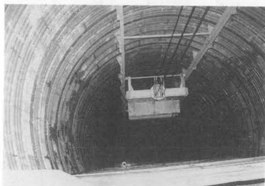
写真-3 坑内運搬設備
