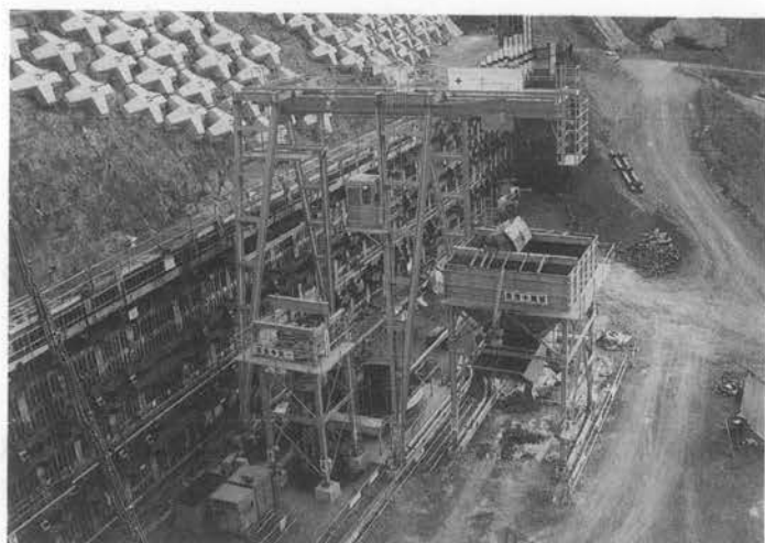
写真-2 ずり出し設備
