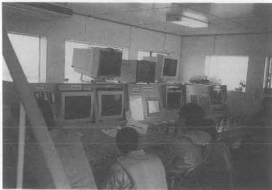
写真-2 集中管制監視システム
