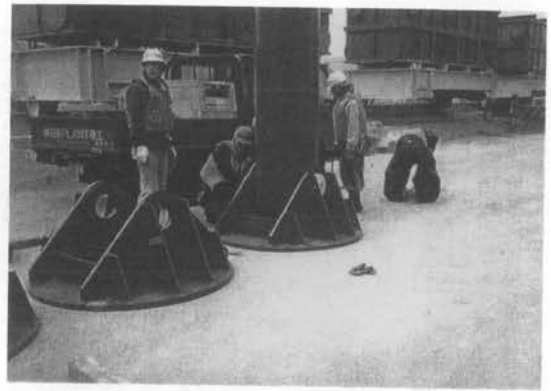
写真-4 レグ支柱板
