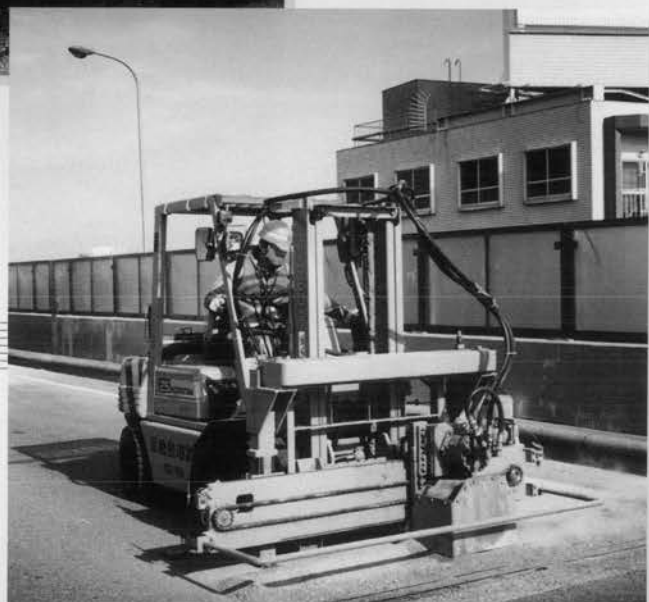
⇓ 橋脚ジョイント部スライドプレーナ
