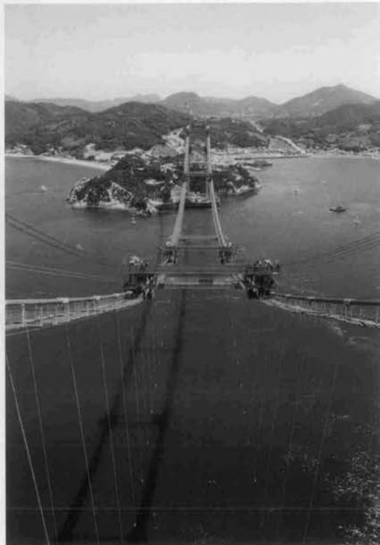
来島第一大橋の桁架設準備作業 ⇨ 4基のリフティングビームの設置が終了し、径間中央に移動中。 3P塔頂より中央径間を望む。
