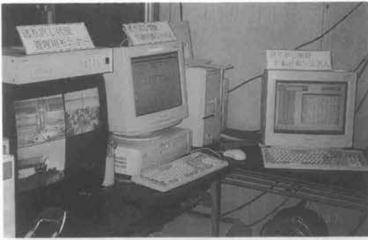
写真-3 集中管理システム
