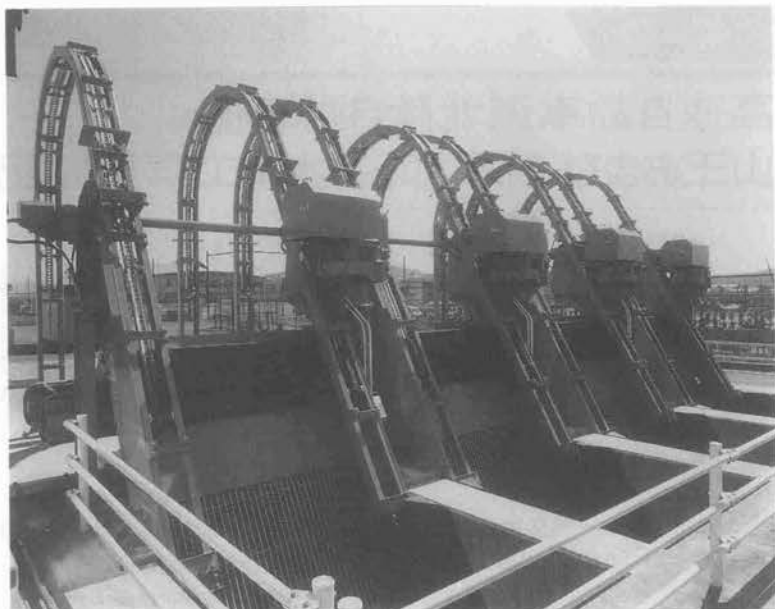
写真-6 仲沖排水機場（長崎県）簡易除塵機
