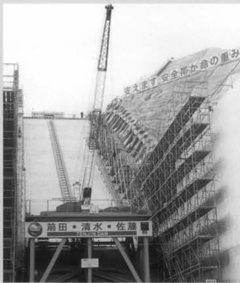
⇩ 洪水吐急流部斜行クレーン
