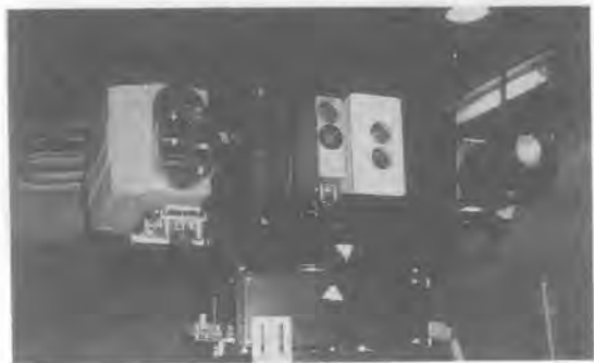
写真-2 計測機部分
