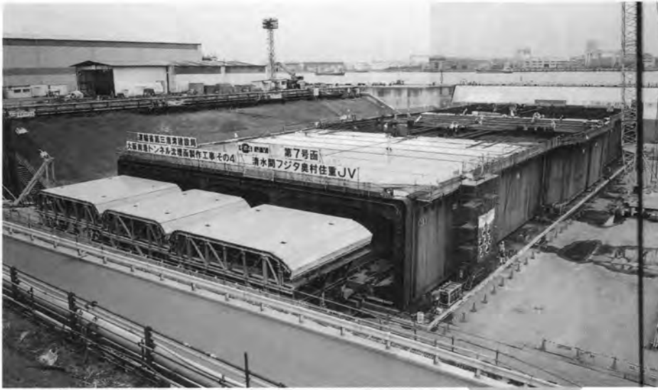
↑上床版 型枠トラベラー
