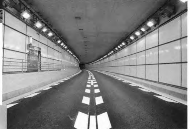
↑トンネル照明
