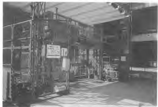
写真-1 工用エレベータ
