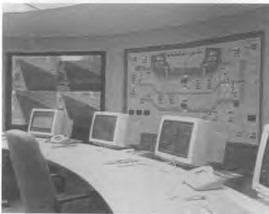
写真—4 中央監視室
