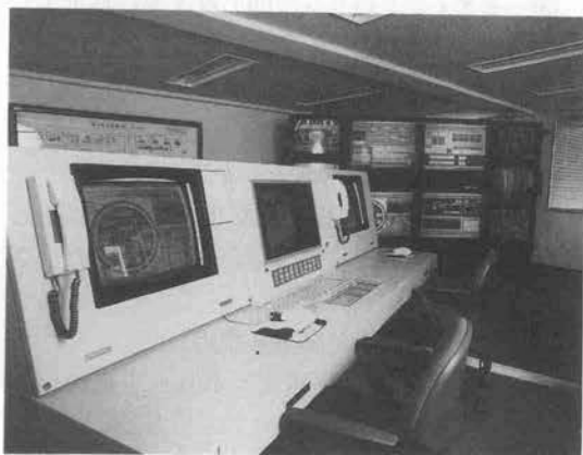
写真-4 東京湾横断道路工（浮島南JV）の自動運転操作盤およびマルチビジョン画面
