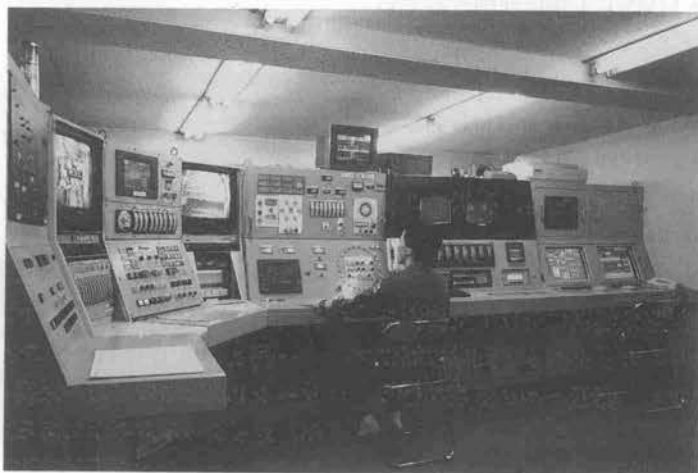
写真-3 総合管理システムによる地上からの遠隔操作運転状況
